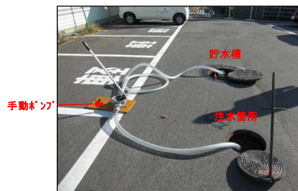
手動ポンプ設置状況
