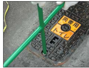
災害用トイレ8基
