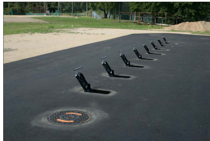
災害用マンホールトイレ全景写真
