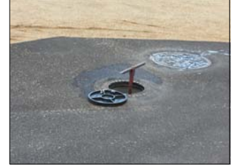
仕切弁・貯水槽蓋
