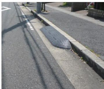
×切り下げ工事をせずに、プラスチック製のステップ板を設置している箇所
