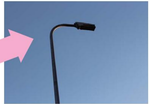
LED化した道路照明灯
