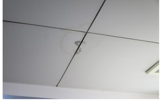
天井の結露痕
