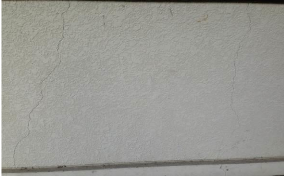
外壁のひび割れ
