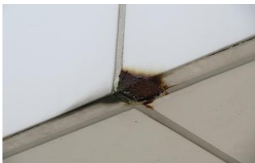
屋上テラスパネルの劣化
