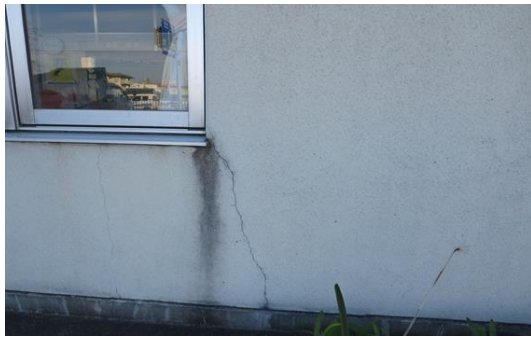
外壁開口部周辺のひび割れ
