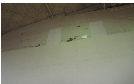
内部仕上げの劣化
