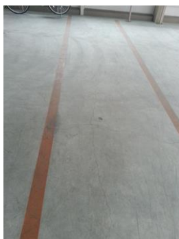
床面のひび割れ
