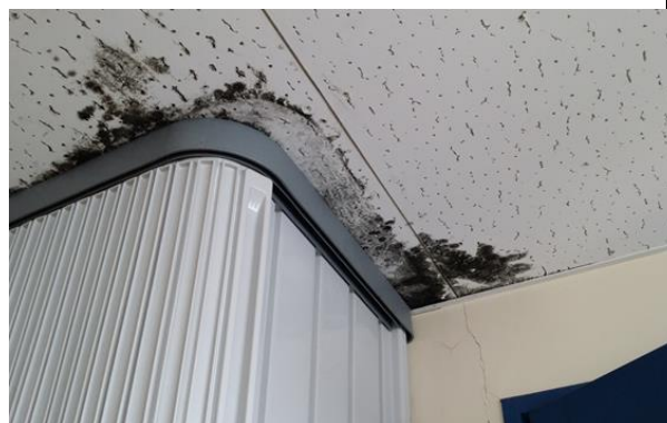
天井の雨漏り
