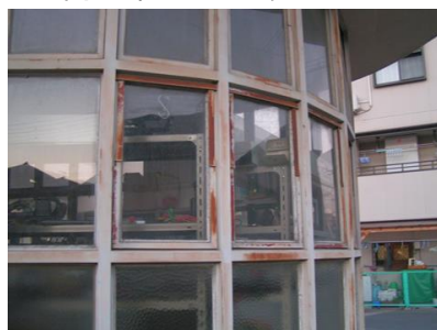
開口部サッシの劣化
