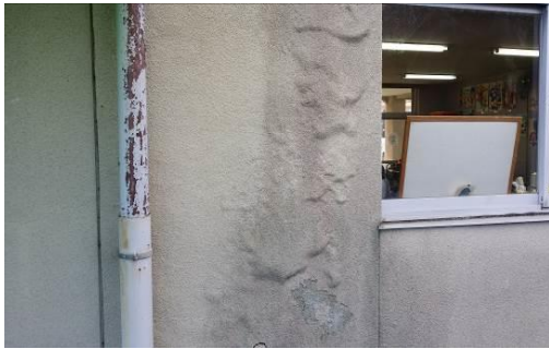
外壁塗装の浮き
