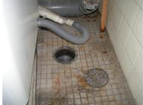
排水設備の劣化
