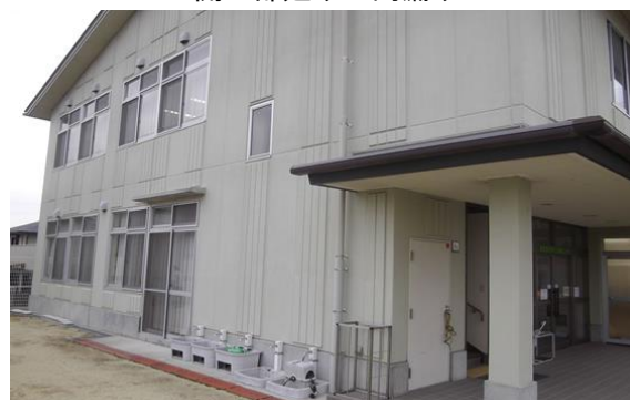
開口部廻りの雨漏り
