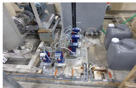
建築設備の劣化
