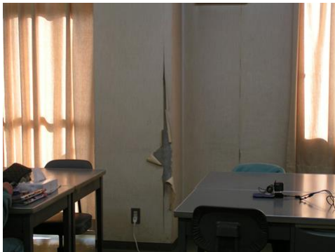
内部仕上げの劣化
