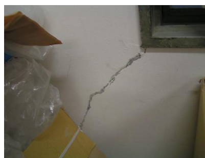
開口部付近のひび割れ
