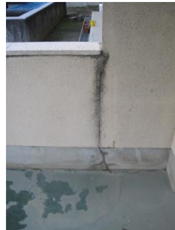
外壁開口部周辺のひび割れ
