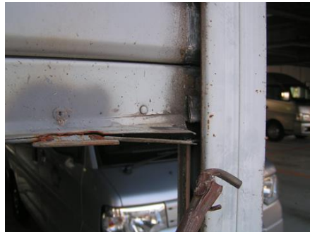
シャッターレールの劣化
