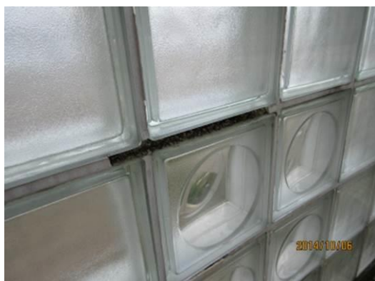
はめ殺し窓の劣化
