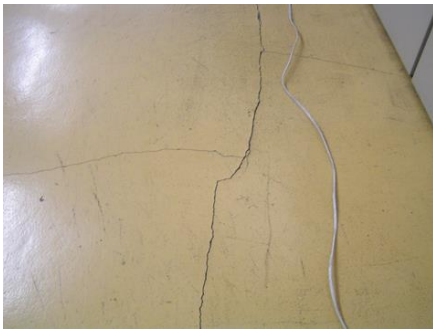
内部床面のひび割れ
