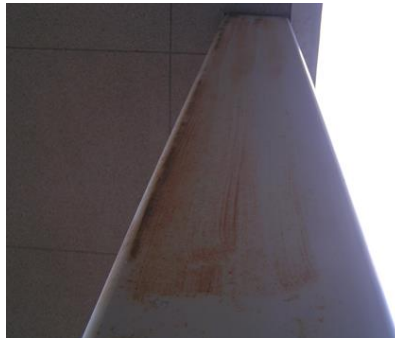
外部鉄骨柱の錆
