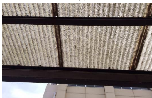
トタン屋根の劣化
