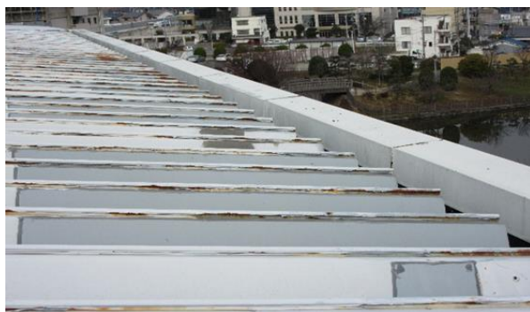
屋根材の劣化
