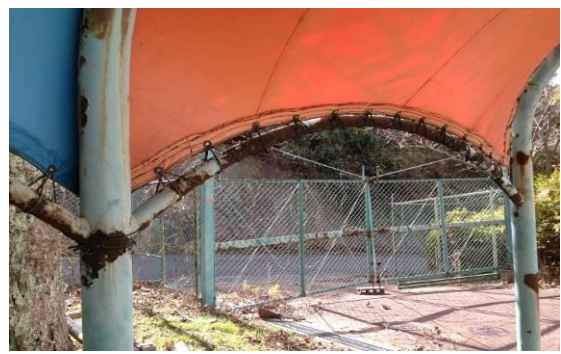
プールサイド日よけテントの劣化
