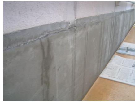
基礎立ち上がり部分の劣化
