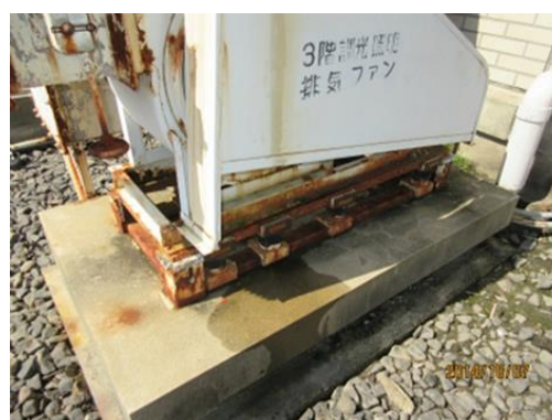
屋外設備の劣化
