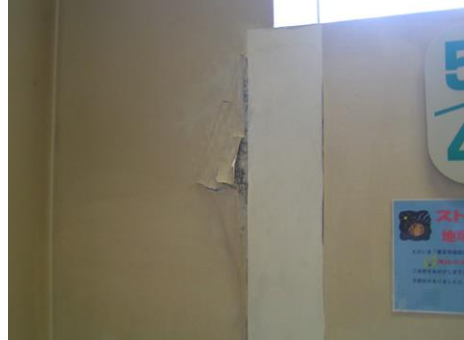
開口部付近のひび割れ
