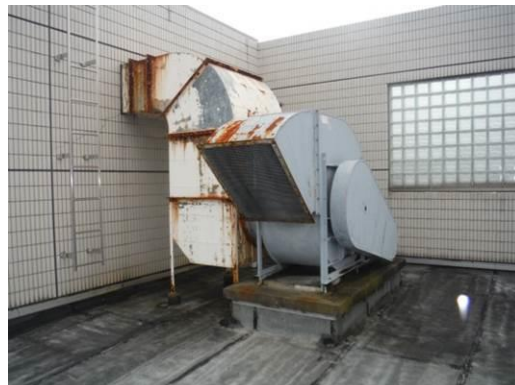
屋外設備の劣化
