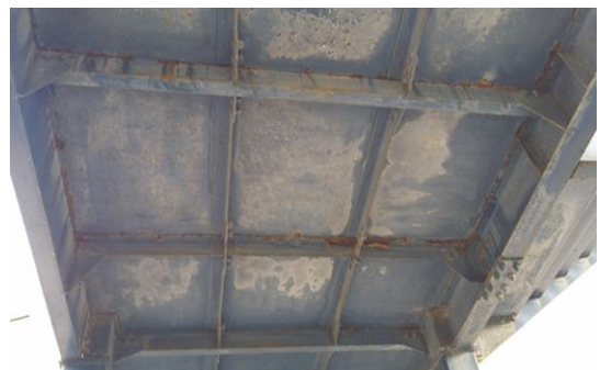
屋外階段の劣化
