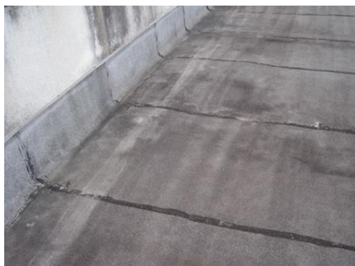
防水層の劣化
