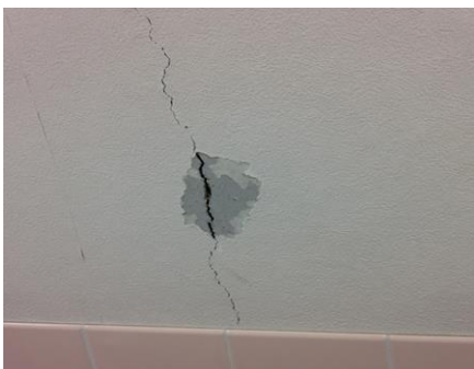
内部仕上げのひび割れ
