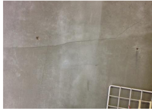
内壁のひび割れ
