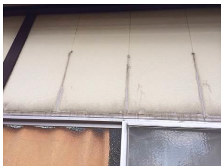
外部開口部の劣化
