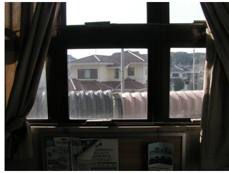
内部サッシの劣化
