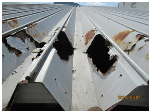
屋根材の劣化
