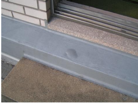
防水層のふくれ
