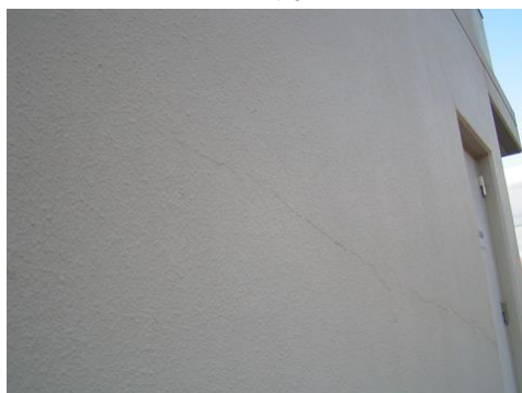
外壁のひび割れ
