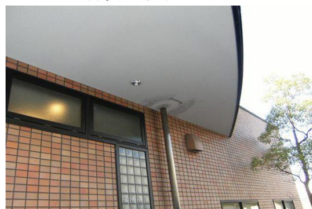
軒裏の漏水跡
