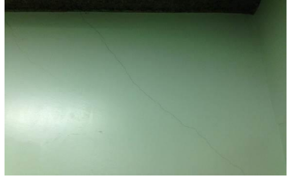
内部仕上げのひび割れ
