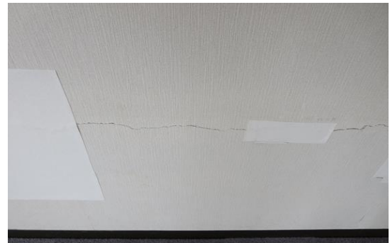
内部仕上げのひび割れ
