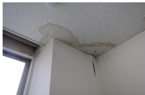
天井の雨漏り
