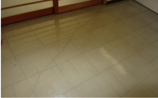
廊下のひび割れ
