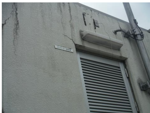
外壁開口部周辺のひび割れ
