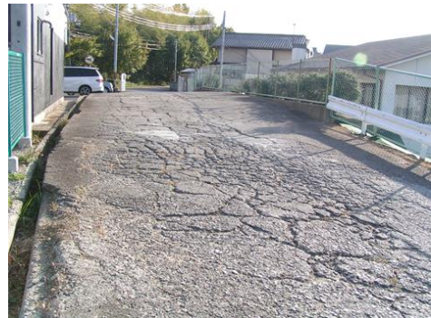
外構舗装のひび割れ
