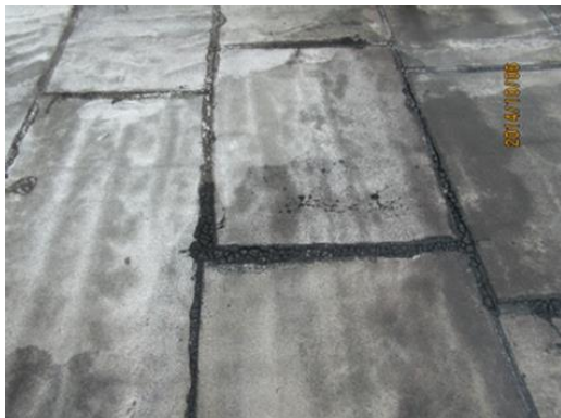
屋上防水の劣化
