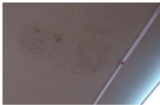
屋根・屋上の劣化
