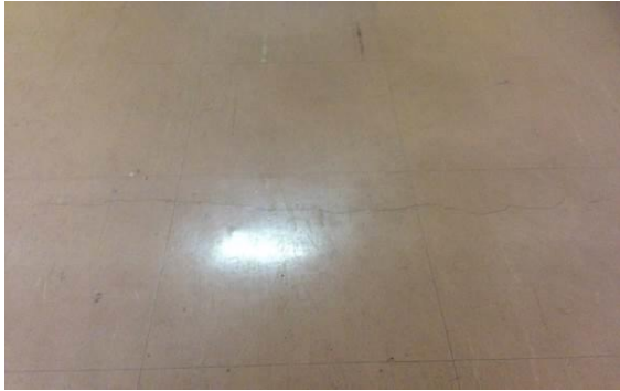
床面のひび割れ
