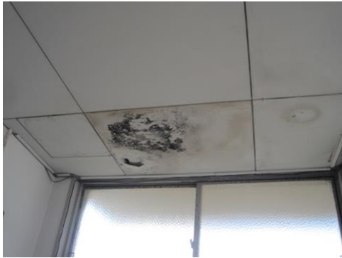
天井の雨漏り
