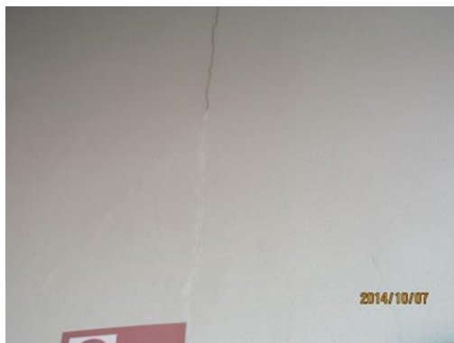
内部仕上げのひび割れ
