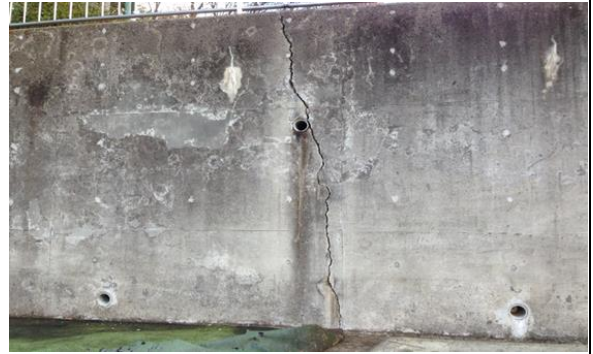
プールサイド壁面の劣化
