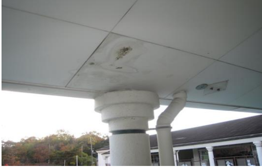
漏水跡、雨樋の劣化
