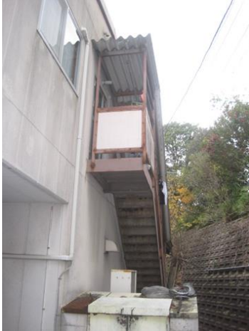
屋外階段の劣化
