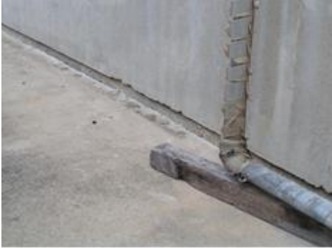
建物周辺の沈下
