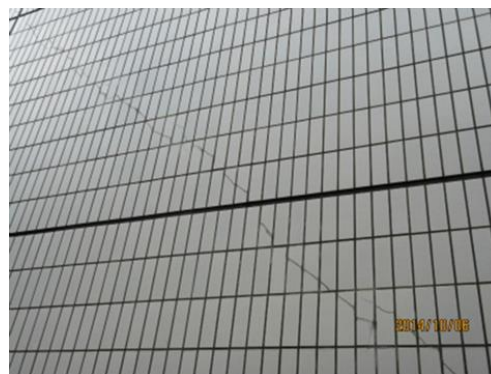
外壁のひび割れ
