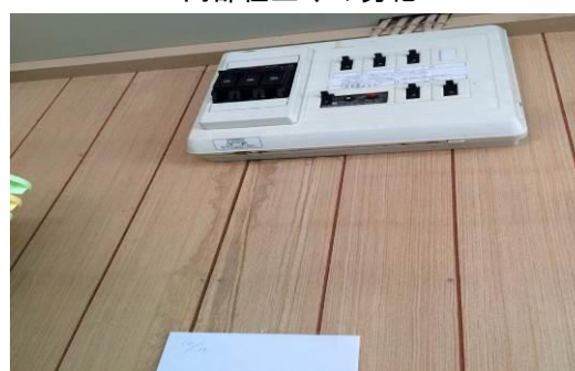
内部仕上げの劣化
