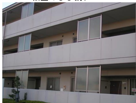
袖壁のひび割れ
