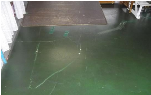
内部床面のひび割れ
