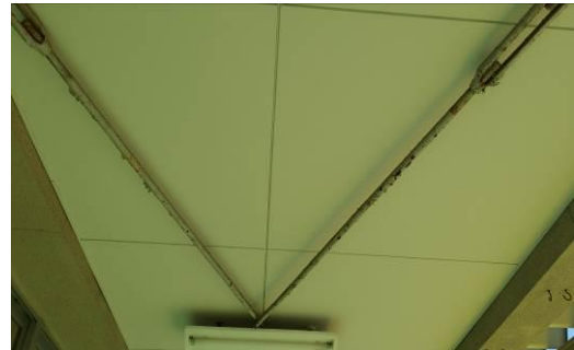
天井ブレースの劣化
