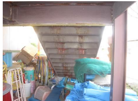
屋外階段の劣化
