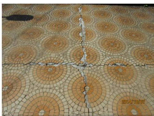
屋外床タイルの劣化
