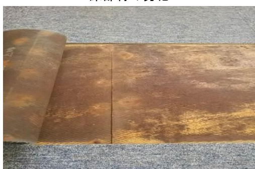
床部材の劣化
