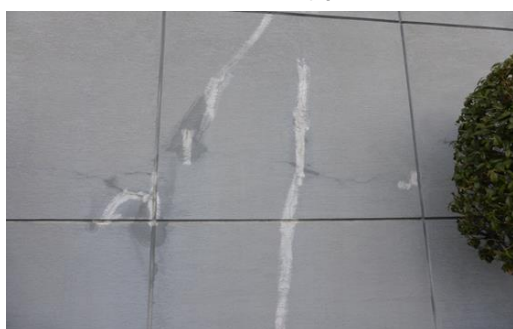
外壁パネルのひび割れ
