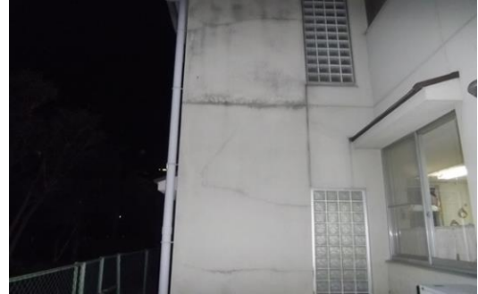
外壁のひび割れ
