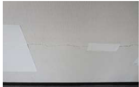
内部仕上げのひび割れ
