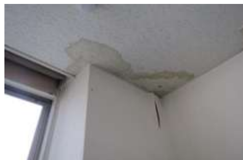
天井の雨漏り
