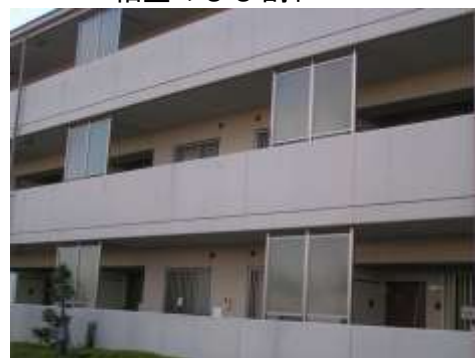
袖壁のひび割れ
