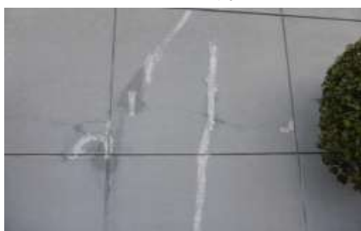
外壁パネルのひび割れ
