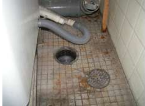
排水設備の劣化
