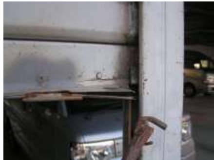
シャッターレールの劣化
