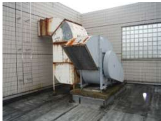
屋外設備の劣化
