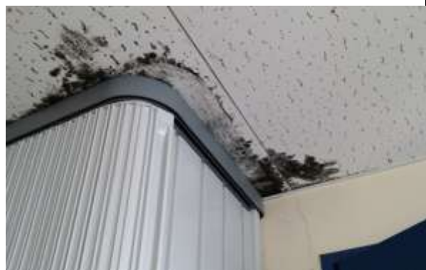
天井の雨漏り
