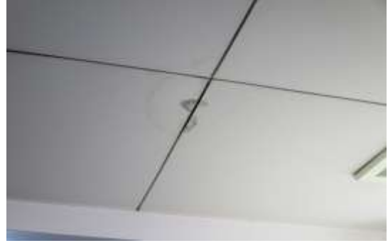
天井の結露痕
