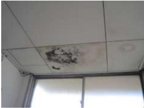
天井の雨漏り
