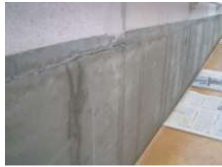
基礎立ち上がり部分の劣化
