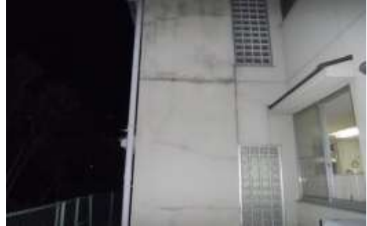
外壁のひび割れ
