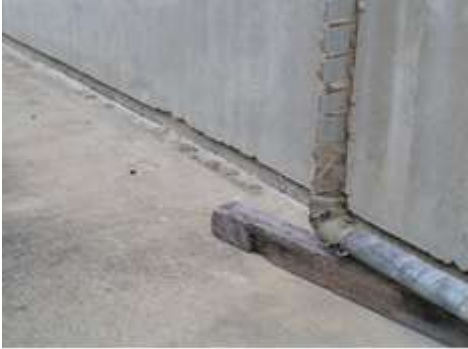
建物周辺の沈下
