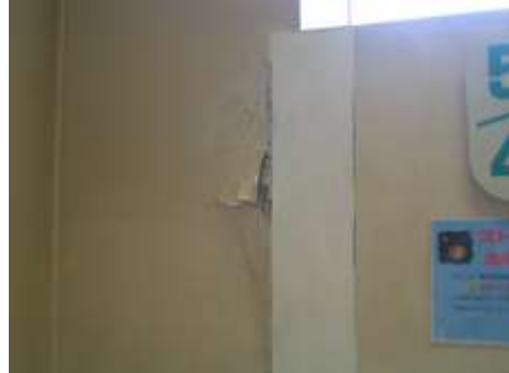
開口部付近のひび割れ
