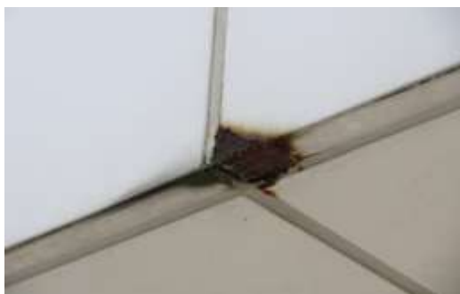
屋上テラスパネルの劣化
