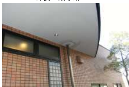
軒裏の漏水跡
