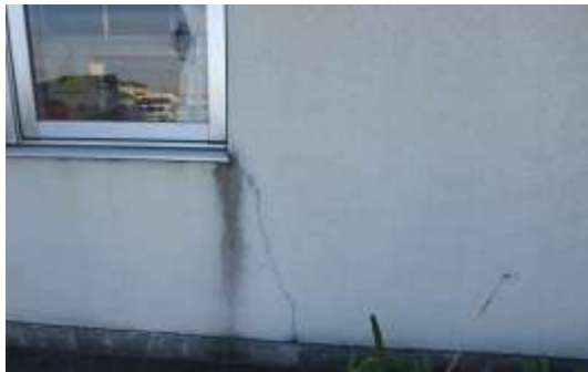
外壁開口部周辺のひび割れ
