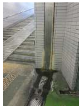
地下の接続部での漏水
