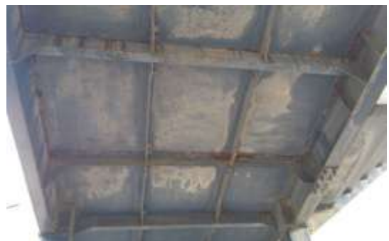
屋外階段の劣化
