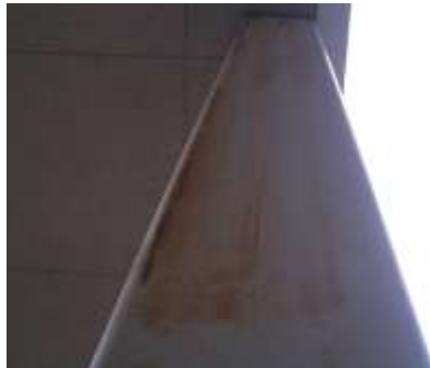
外部鉄骨柱の錆
