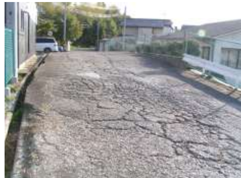
外構舗装のひび割れ
