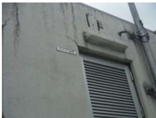
外壁開口部周辺のひび割れ
