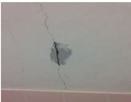
内部仕上げのひび割れ
