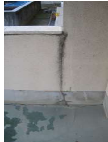
外壁開口部周辺のひび割れ
