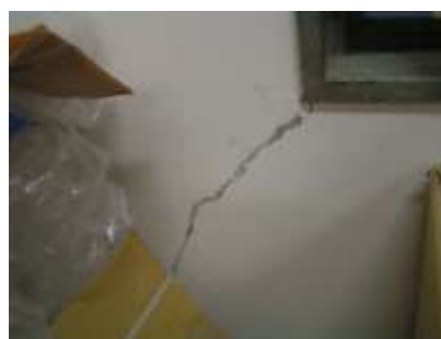
開口部付近のひび割れ
