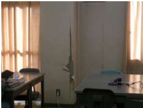
内部仕上げの劣化
