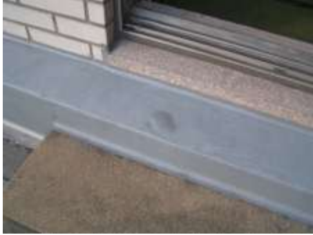
防水層のふくれ
