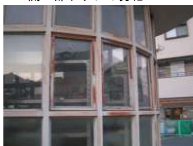
開口部サッシの劣化
