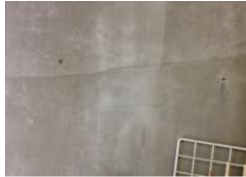
内壁のひび割れ
