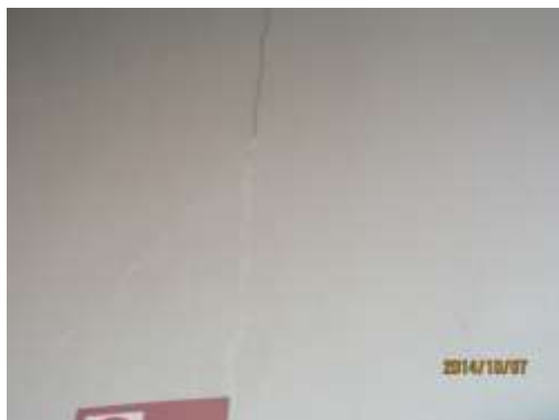
内部仕上げのひび割れ
