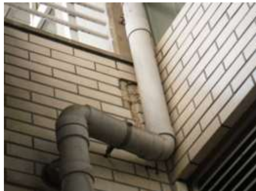
外壁タイルの剥離
