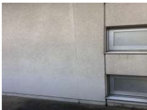
外壁のひび割れ
