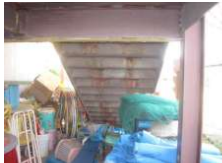
屋外階段の劣化
