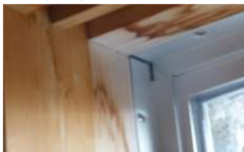
開口部付近の雨漏り
