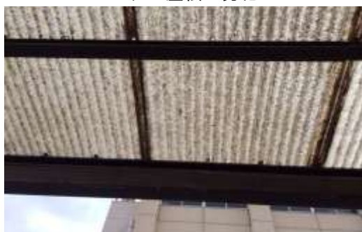
トタン屋根の劣化
