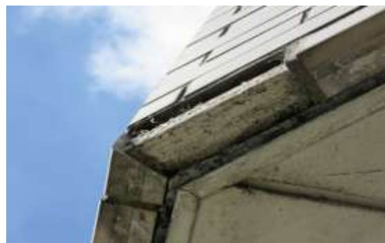
タイルの割れ・剥れ
