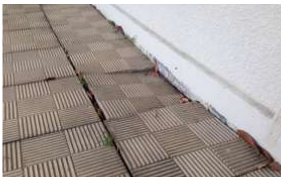
プールサイド床の劣化
