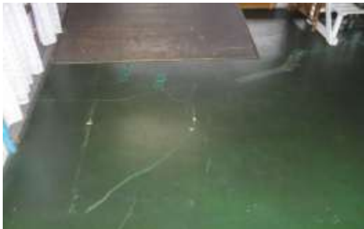
内部床面のひび割れ
