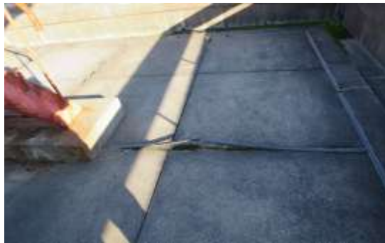
屋上保護防水の劣化
