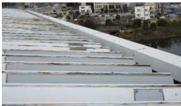
屋根材の劣化
