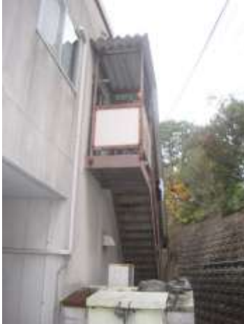
屋外階段の劣化
