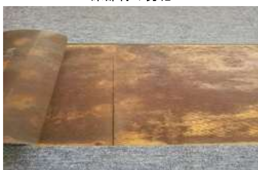
床部材の劣化
