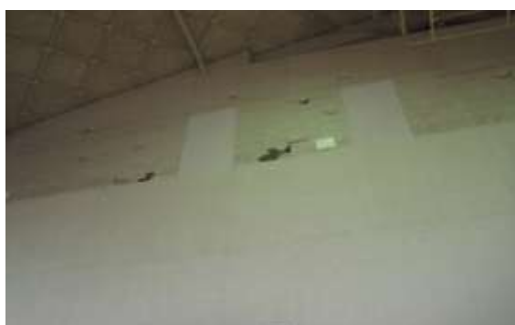
内部仕上げの劣化
