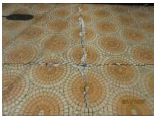
屋外床タイルの劣化
