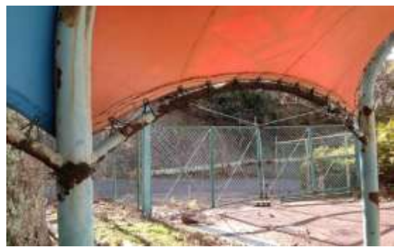
プールサイド日よけテントの劣化
