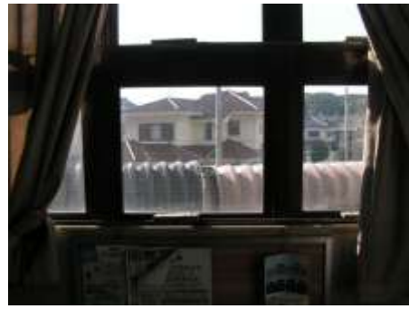
内部サッシの劣化
