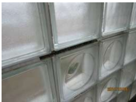
はめ殺し窓の劣化
