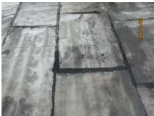
屋上防水の劣化
