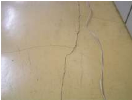
内部床面のひび割れ
