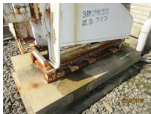
屋外設備の劣化
