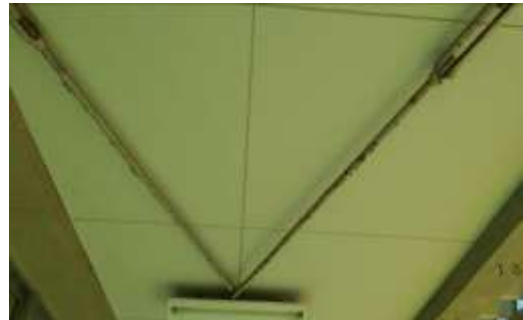
天井ブレースの劣化
