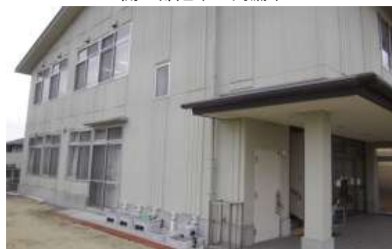
開口部廻りの雨漏り
