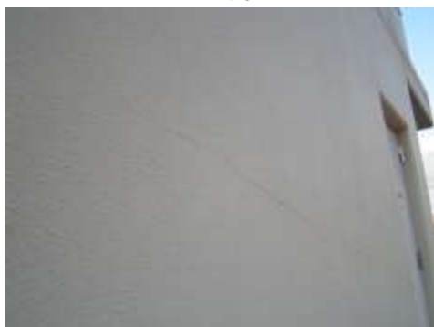
外壁のひび割れ
