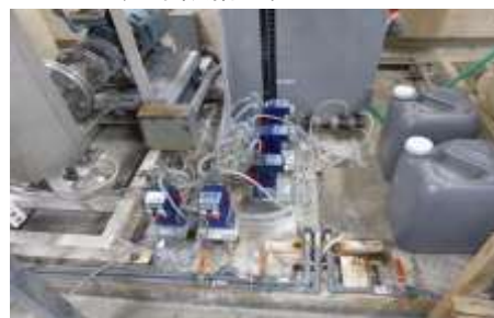
建築設備の劣化
