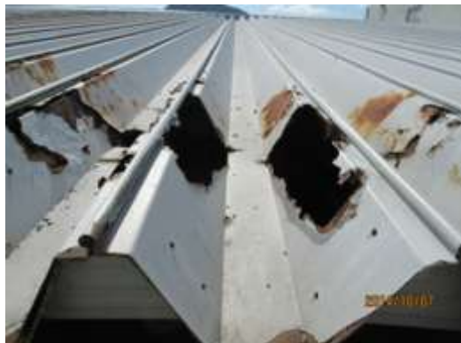
屋根材の劣化
