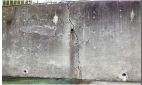
プールサイド壁面の劣化
