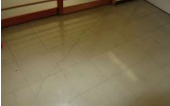
廊下のひび割れ
