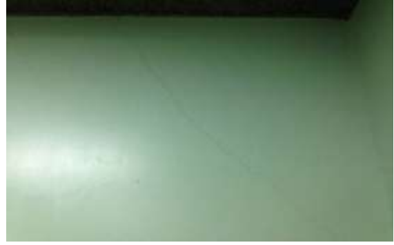
内部仕上げのひび割れ
