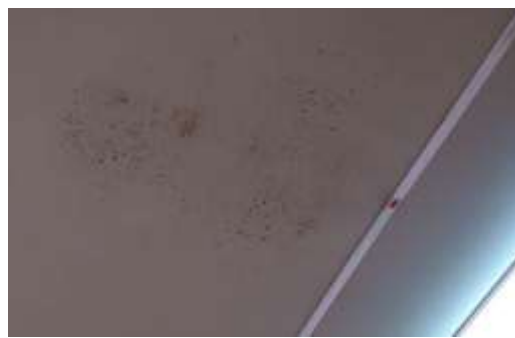
屋根・屋上の劣化
