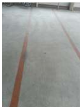
床面のひび割れ
