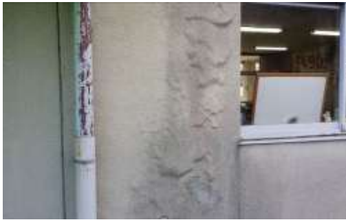
外壁塗装の浮き
