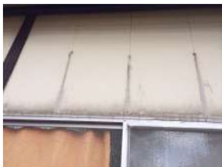
外部開口部の劣化
