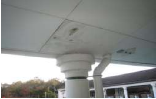
漏水跡、雨樋の劣化
