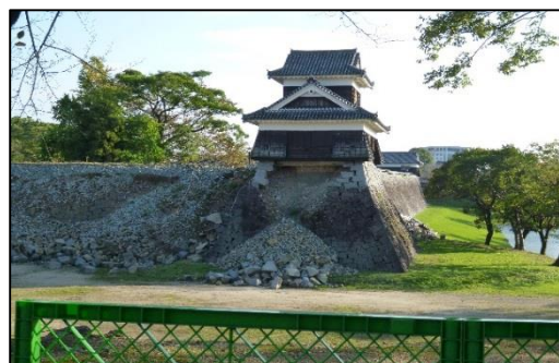
崩落した石垣①
