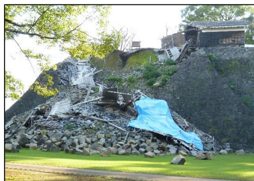
崩落した石垣③
