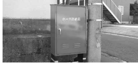
▲市内にある消火栓ボックス
