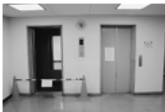
▲一基が休止している庁舎エレベーター
