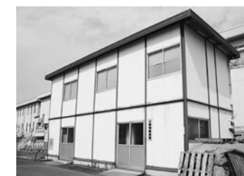
▲市役所会議室棟西側の災害備蓄倉庫
