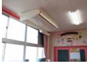
幼稚園の空調設備
