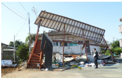
倒壊したアパートの階段
