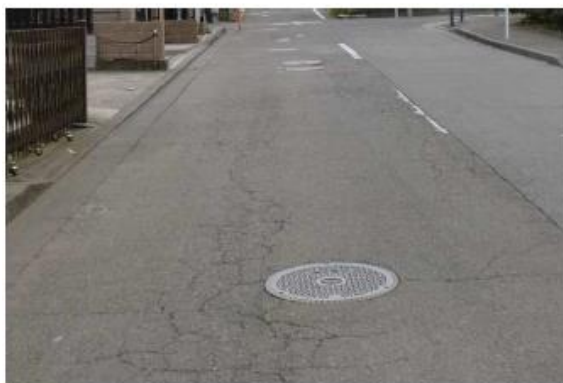
写真 2. 3. 1 舗装のひび割れ
