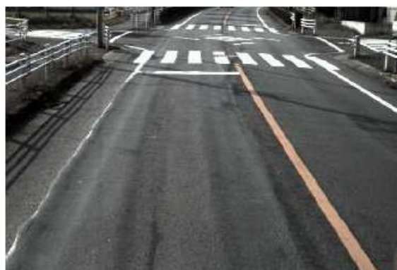
写真 2. 3. 2 舗装のわだち掘れ
